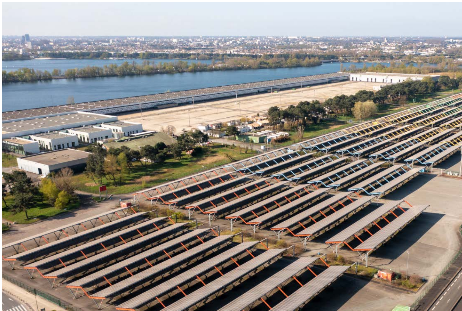
A Bordeaux, un parking couvert d'ombrières photovoltaïques. BORDEAUX MÉTROPOLE
