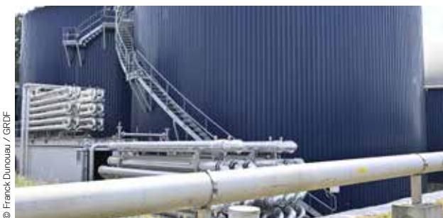
Site de méthanisation à Château-Gontier (53)
