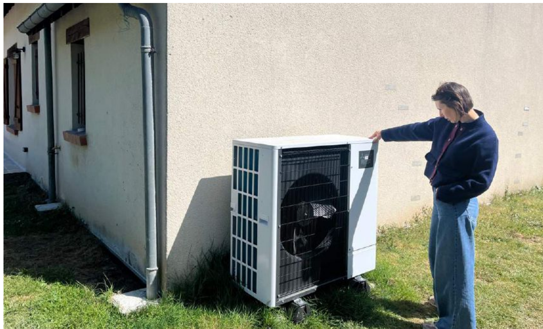
Les pompes à chaleur aérothermiques air/air ou air/eau, sont les plus couramment utilisées. (Photo NR)
