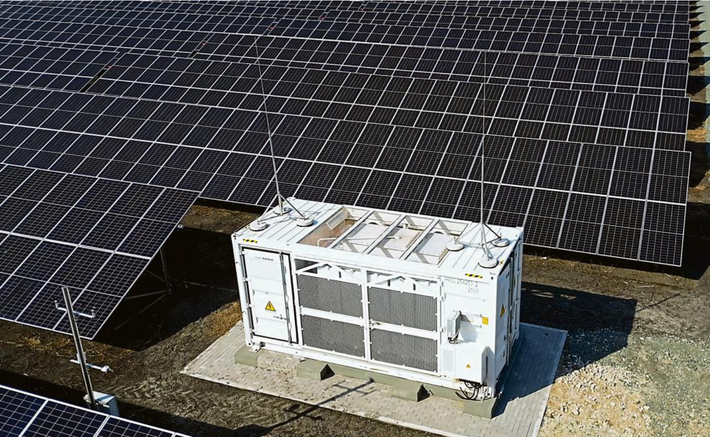
Les mises en concurrence annoncées depuis le début de l'année assurent au solaire 1,5 GW de puissance cumulée.
