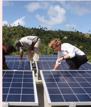
crédit photo : Électriciens sans frontières
