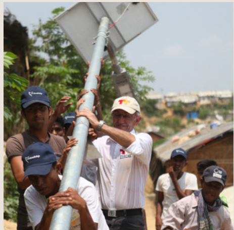
crédit photo : Électriciens sans frontières
